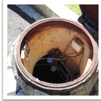
Trappe accès bâche avec système anti-intrusion
