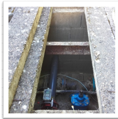
Chambre au pied du réservoir
