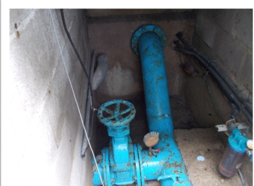
Conduite de refoulement et arrivée de P4
