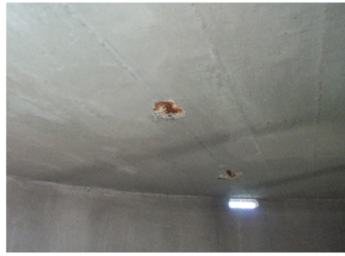
Armatures visible en sous-face de couverture
