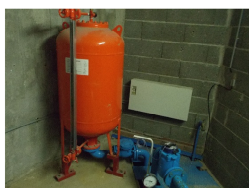
Ballon anti-bélier à réhabiliter
