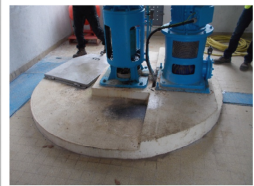
Tête du forage et moteur des pompes
