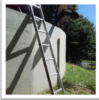
Accès au toit bâche avec échelle mobile
