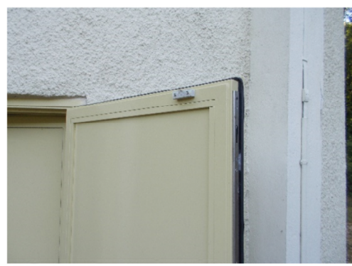
Porte entrée double avec système anti-intrusion
