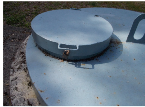
Tête du forage cadenassé
