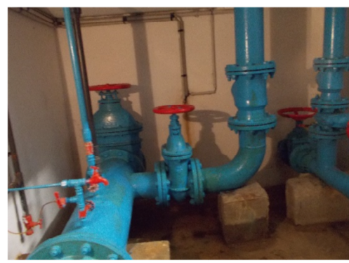
Conduite de refoulement vers Paucourt et RN7
