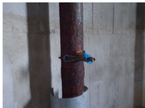
Piquage sur conduite de distribution (corrodée)
