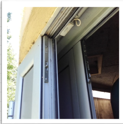
Porte entrée double avec système anti-intrusion
