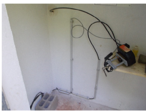
Local de stockage du Chlore (vide)
