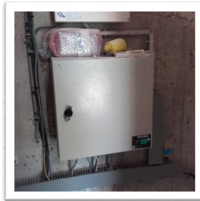
Armoire télégestion Sofrel à remplacer
