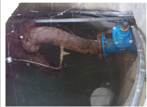
Conduite de distribution
