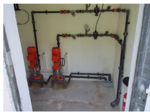
Local de chloration
