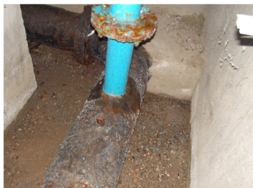
Conduite de refoulement vers Paucourt (corrodée)
