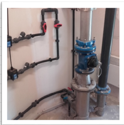
Conduite refoulement et chloration
